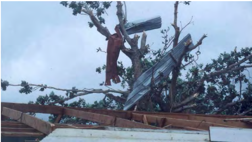
Effets des vents cycloniques – 2010 – Tubuai - OLI
